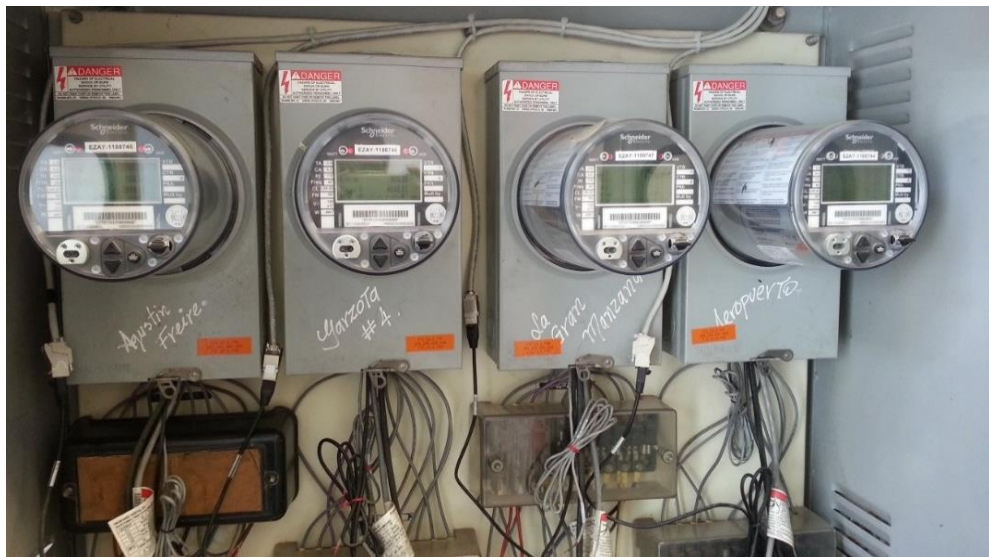
Figura 1.14 Medidores Schneider en la S/E Garzota.
