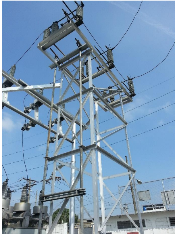
Figura 1.3 Vista de estructura de 69 [KV].
