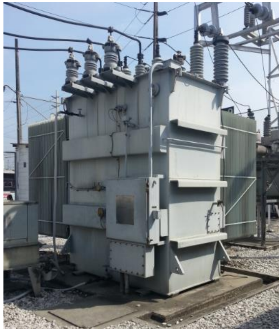
Figura 1.8 Transformador principal de la Subestación Garzota
