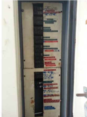
Figura 1.17 Breakers montados en el panel de control.
