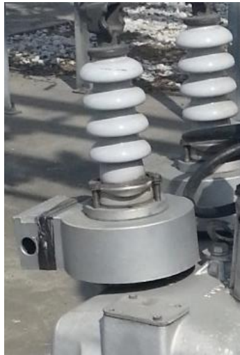
Figura 1.12 Transformadores de corriente en subestación Garzota.
