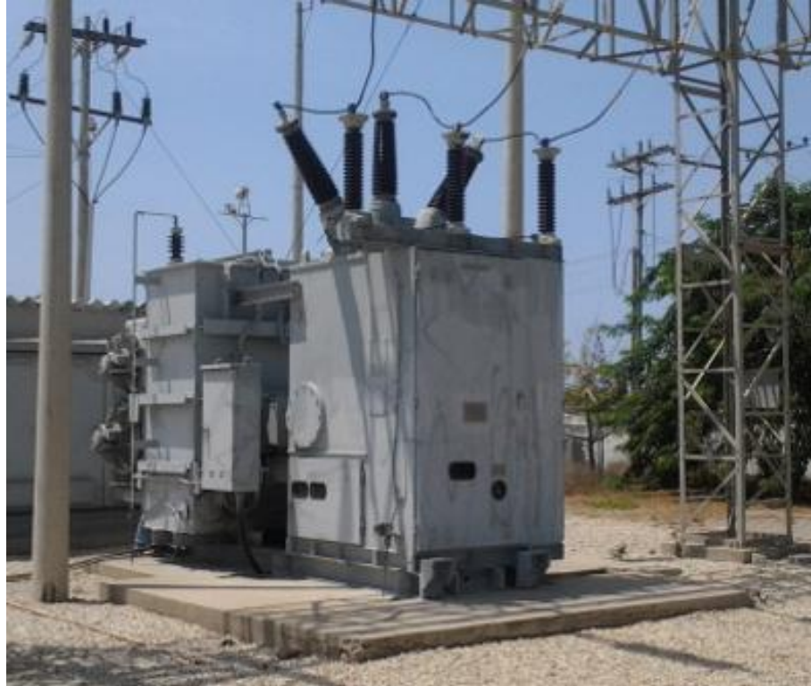
Figura 1.10 Transformador de Potencia
