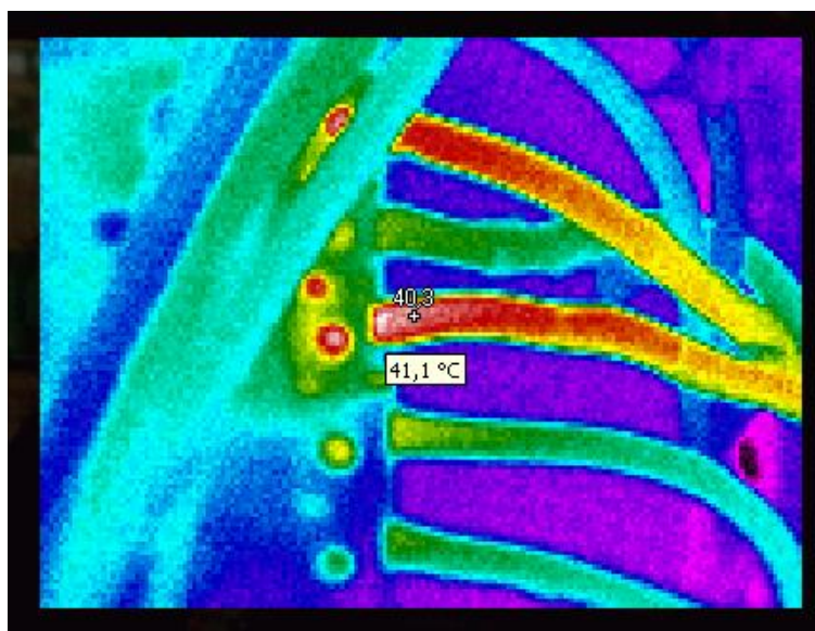
Figura 3.3.4.5 Salida del Breaker.
