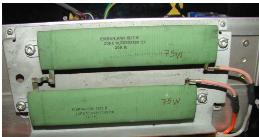
Figura 2.26: Resistencias de potencia del circuito de estabilización del voltaje de la barra DC.
