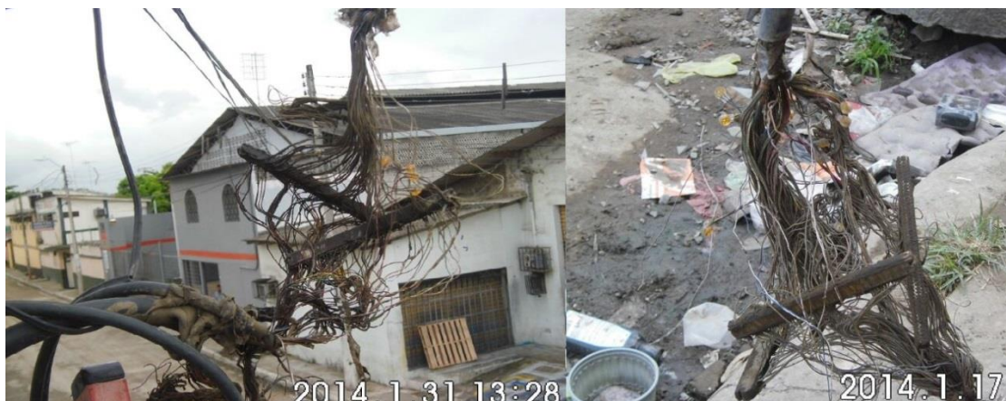
Fig. 4. 12 Empalmes a la intemperie.
