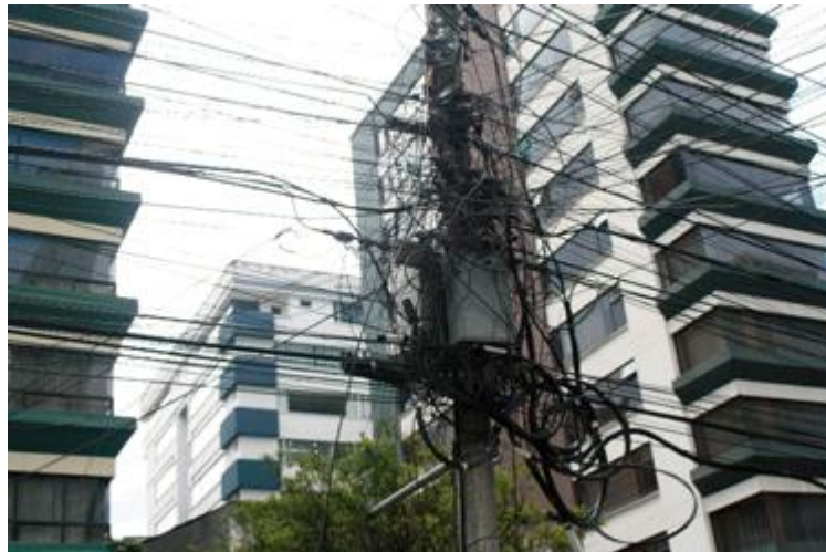
Fig. 4. 9 Cableado de datos junto a transformador eléctrico.
