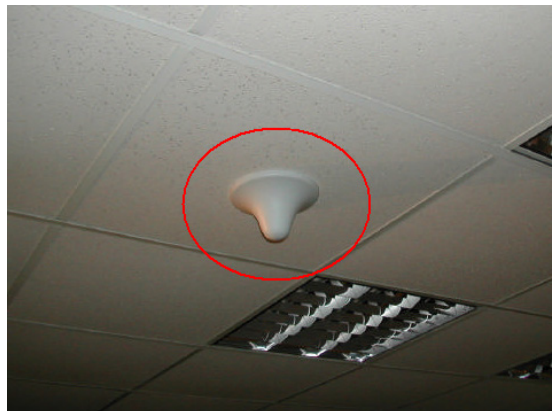
Figura 3.10 Antena omnidireccional montada en el cielo falso
