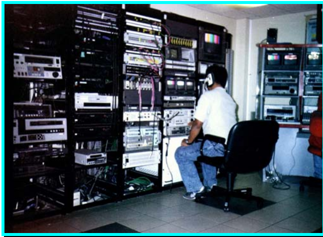
Figura 2.5 Sala de Control Técnico: Gamavisión
