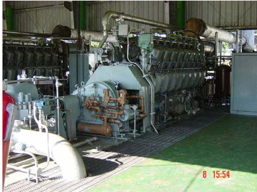
Unidad de Bombeo
