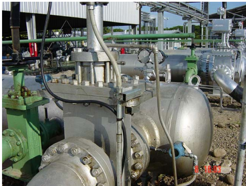
Intercambiador de Calor
