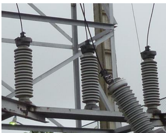
Figura 1.7 Pararrayos en estructura 69KV
