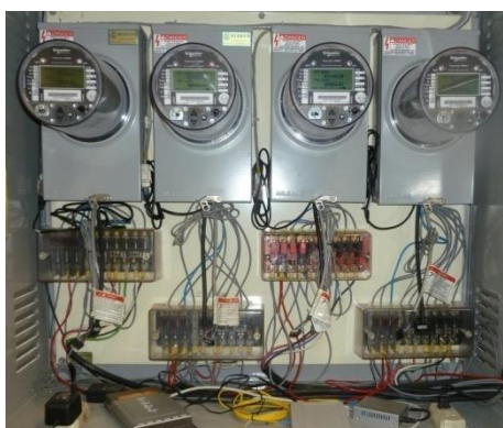
Figura 1.16 Medidores Schneider en la S/E Cerro Blanco
