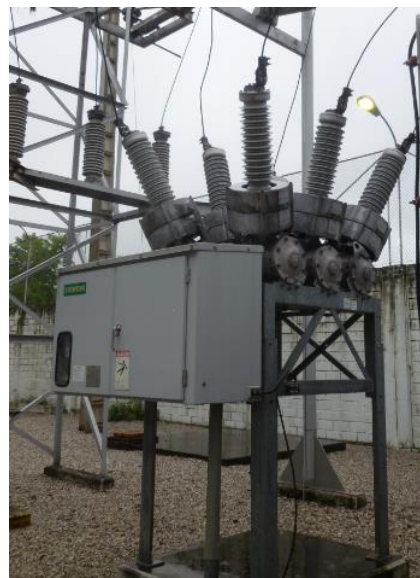
Figura 1.6 Interruptor en Gas SF6
