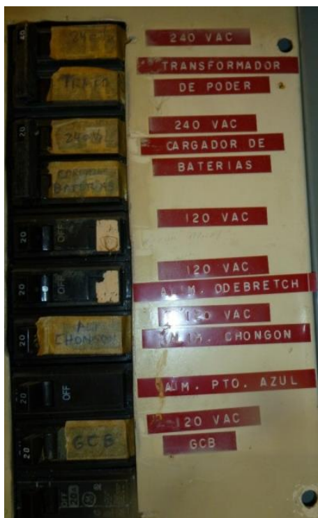
Figura 1.19 Varios breakers montados en el panel de control.
