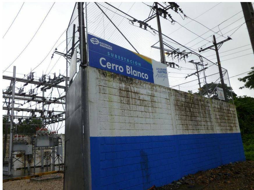
Figura 1.3 Vista exterior de la Subestación CERRO BLANCO.
