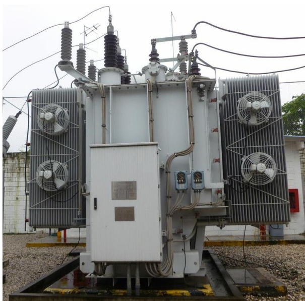
Figura 1.9 Transformador de potencia 67000 /13800 V, marca ABB
