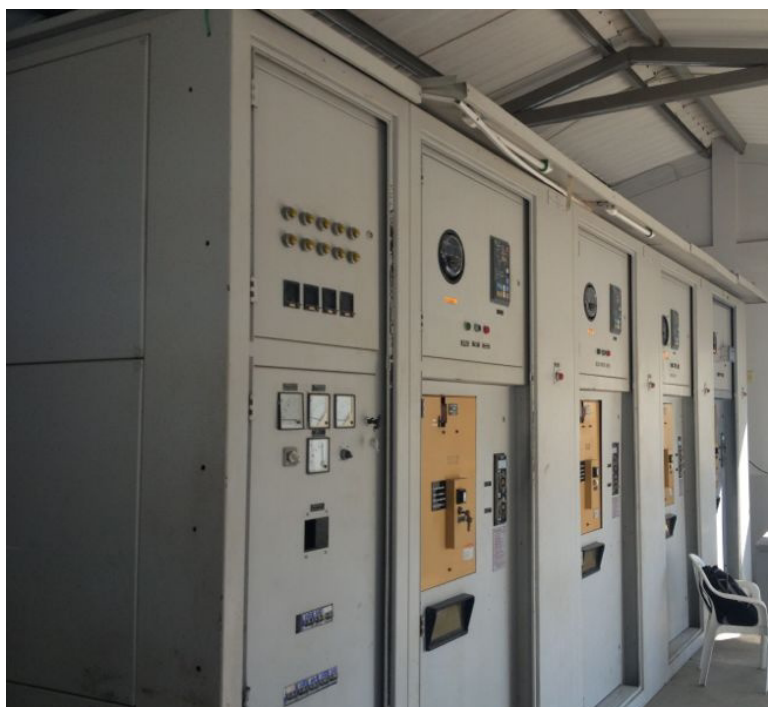
Fig 1.6 Sala de Tableros de 13.8 kV S/E Carolina
