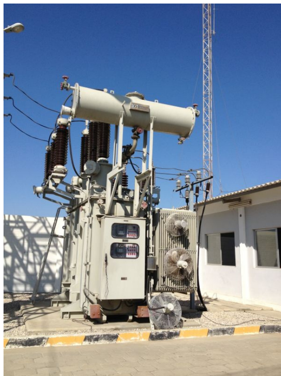
Fig 1.5 Transformador de Fuerza S/E Carolina
