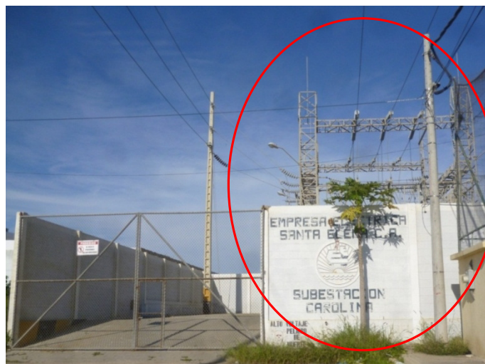
Fig 1.3 Pórtico de S/E Carolina
