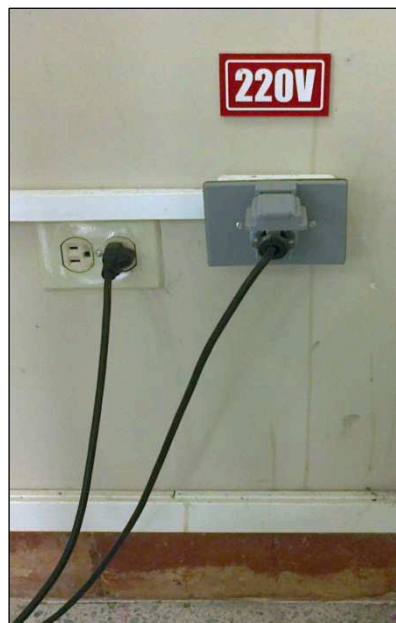
Figura 2.11. Instalación Eléctrica Adicional de 220[V]_{AC}
