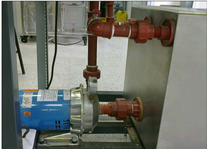
Figura 1.10. Vista de la Derivación a la Salida de la Bomba
