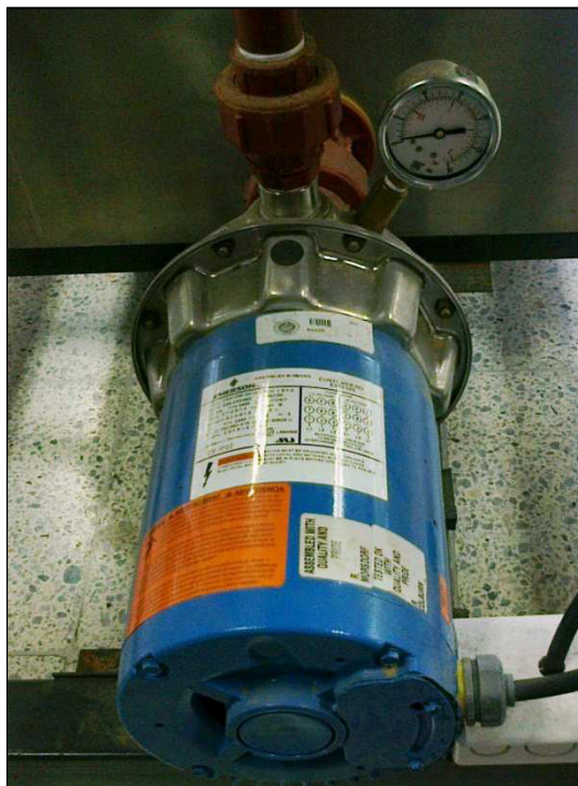
Vista de la Bomba y Manómetro
