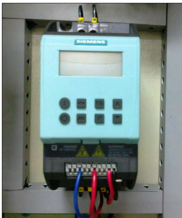
Vista del Variador de Frecuencia
