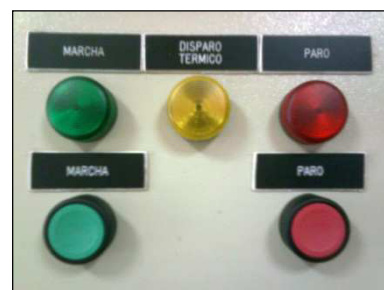
Figura 1.15. Vista de las Luces Piloto y Pulsadores
