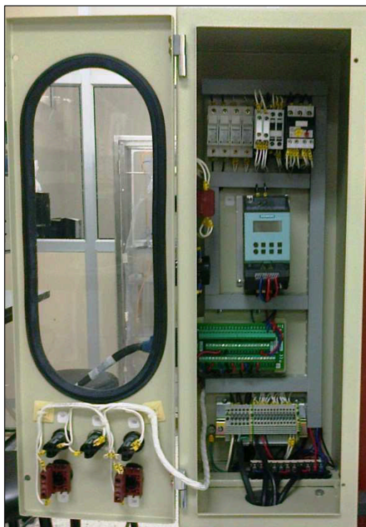
Vista del Panel Eléctrico
