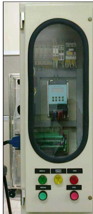
Figura 1.12. Vista Frontal del Panel Eléctrico
