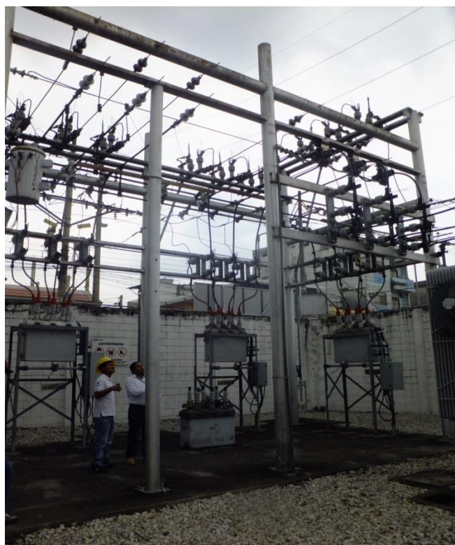
Figura #1. 21 Estructura y componentes del patio de 13.8kV.
