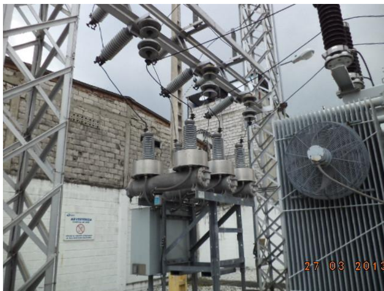
Figura 1. 8 Interruptor en SF6
