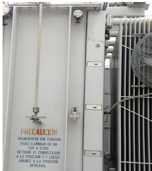
Figura #1. 15 Cambiador de derivaciones sin carga.
