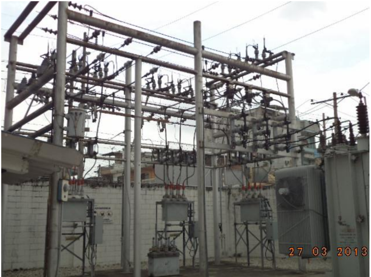
Figura #1. 4 Aparamenta del patio de 13.8kV.
