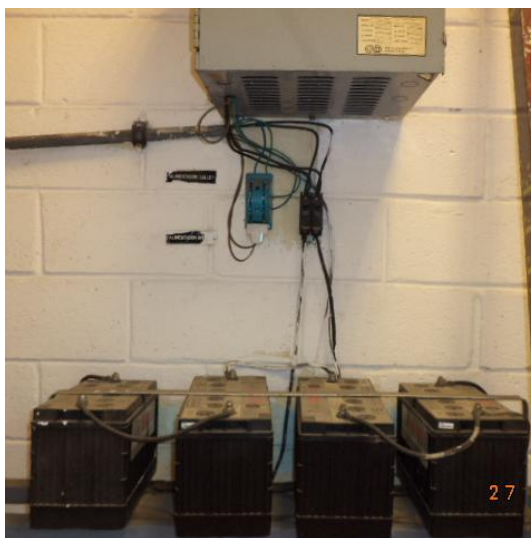
Figura #1. 26 Banco de baterías
