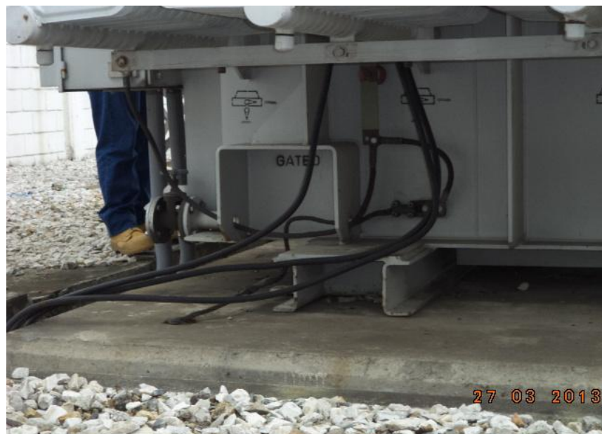
Figura #1. 14 Puntos de puesta a tierra del tanque (continuación).
