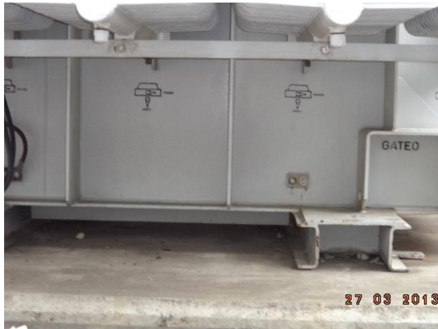
Figura #1. 13 Puntos de puesta a tierra del tanque
