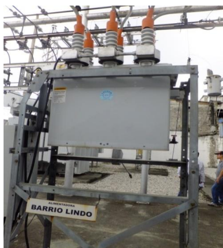
Figura #1. 24 Reconectador “Barrio Lindo”
