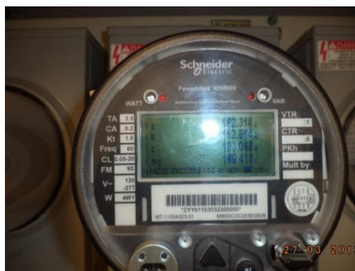
Figura #1. 28 Medidor totalizador
