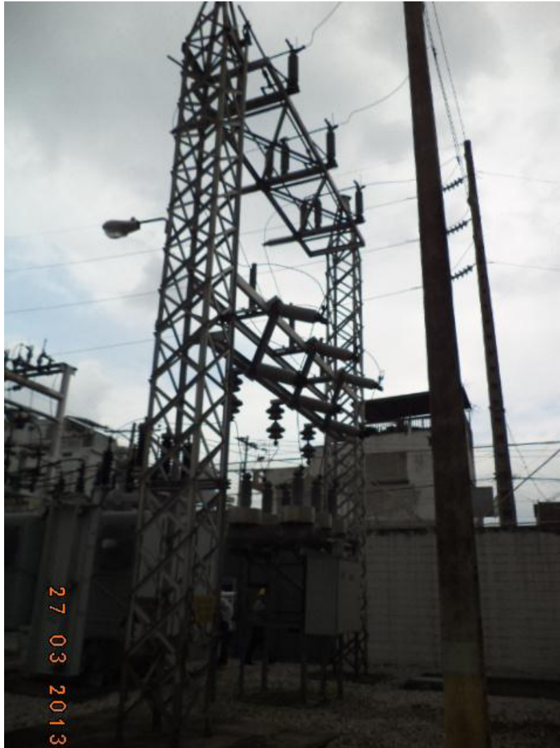
Figura #1. 3 Apartamenta del patio de 69kV.
