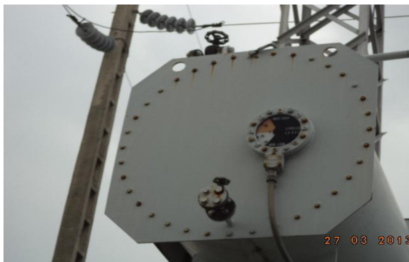
Figura #1. 19 Indicador de nivel de aceite con contactos desmontables y registradores de descarga a tierra.
