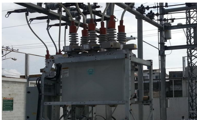
Figura 1. 10 Reconectores de 15 Kv
