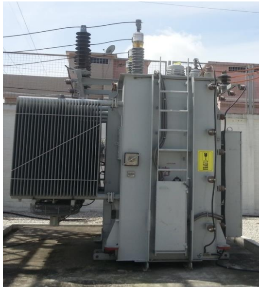
Figura 1. 6 Transformador De Poder 18/24 MVA
