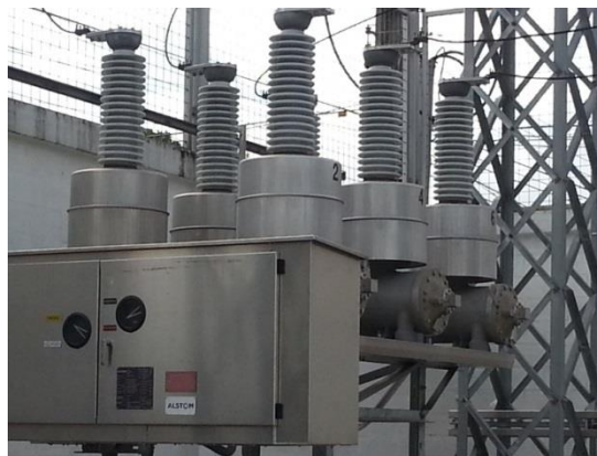
Figura 1. 5 Breaker Gcb 69 Kv Tanque Muerto
