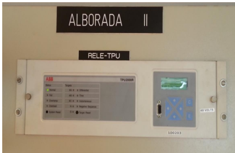
Figura 1. 17 Rele de Protección para Transformador (Tpu)
