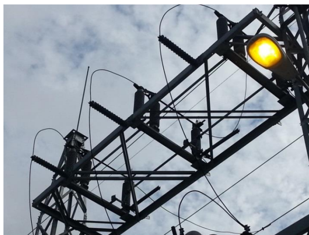
Figura 1. 2 Seccionador tripolar motorizado con cuchillas de tierra
