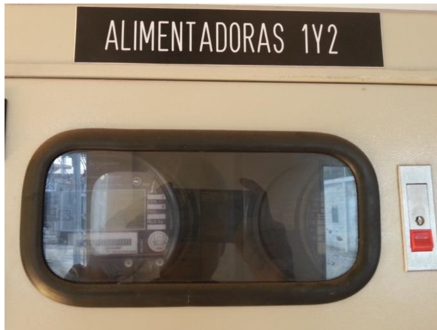
Figura 1. 13 Medidor Alimentadoras 1 y 2
