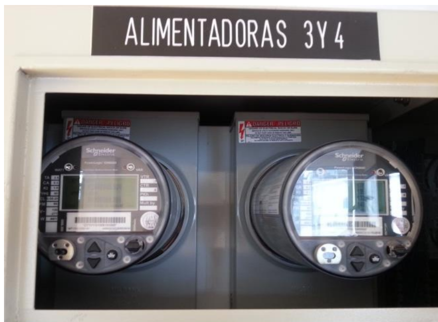
Figura 1. 14 Medidor Alimentadoras 3 y 4
