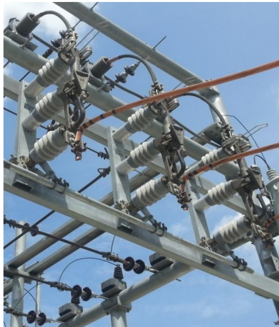
Figura 1. 7 Seccionador Tripolar 15 Kv 1200 a
