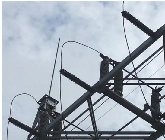
Figura 1. 4 Aislador Tipo Estación
