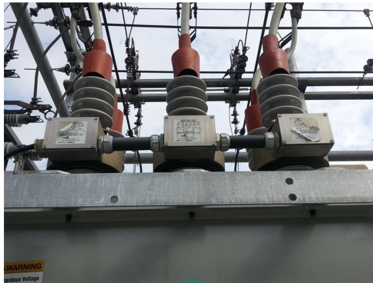
Figura 1. 11 Seccionador Monopolar 15 Kv
