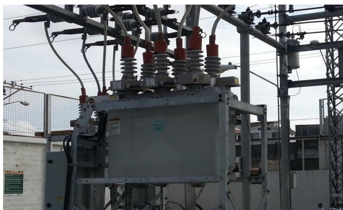
Figura 1. 10 Reconectores de 15 Kv
