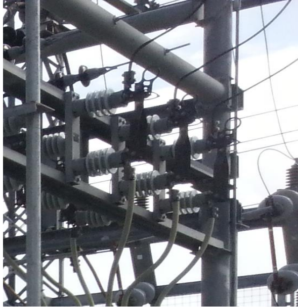
Figura 1. 8 Seccionador Tripolar 15 Kv 600a
