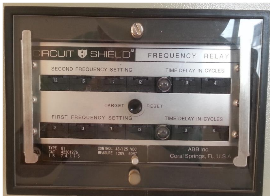
Figura 1. 15 Rele de baja Frecuencia
