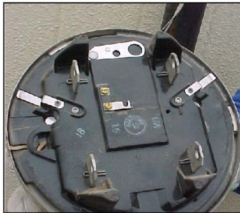
FIGURA 3 – 04: PUENTE DE BOBINA ABIERTO
