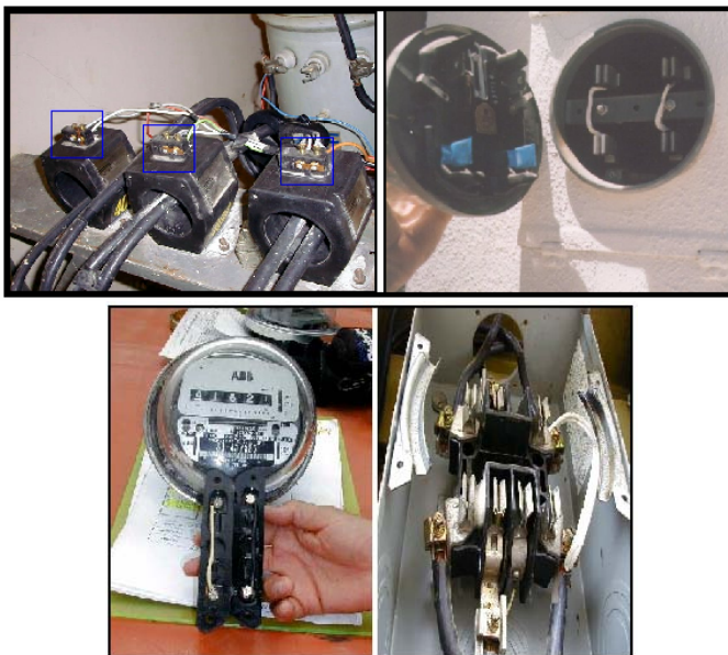
FIGURA 3 – 05: BOBINA DE CORRIENTE PUENTEADA
