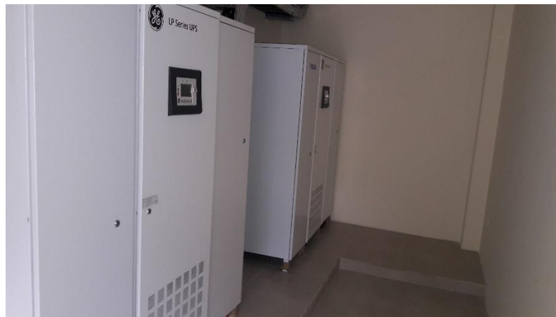
Figura 3.9: Cuarto de transferencia automática y del UPS 1 y UPS 2
