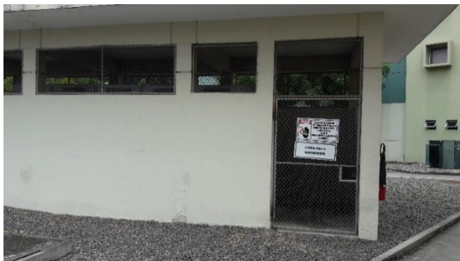
Figura 3.6: Cuarto de celdas # 2
