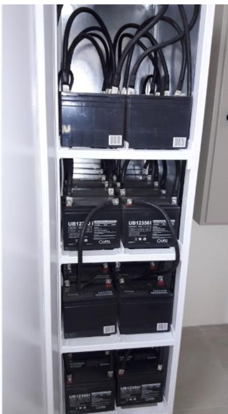
Figura 3.10: Gabinete de baterías de respaldo del UPS 1
