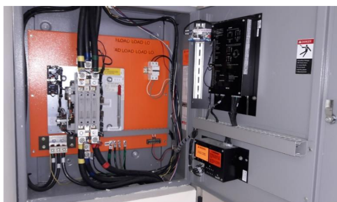
Figura 2.3: Tablero de transferencia automática del edificio 15 A
