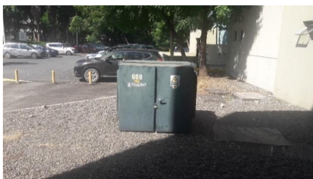
Figura 3.7: Transformador de distribución del edificio 15A
