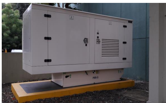
Figura 3.11: Generador a diésel marca FG WILSON
