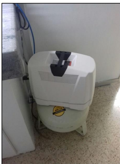
Figura 2.9: Compresor de Aire CIBE ESPOL
