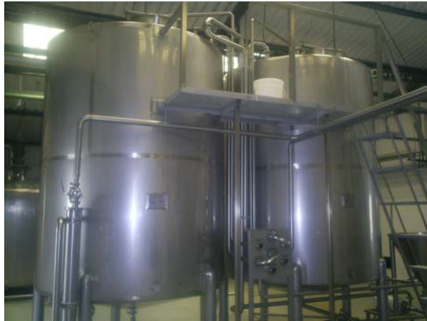
Fig. 2.17 Foto tanques de mezcla ciclo 3
