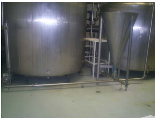
Fig. 2.16 Foto líneas de distribución ciclo II
