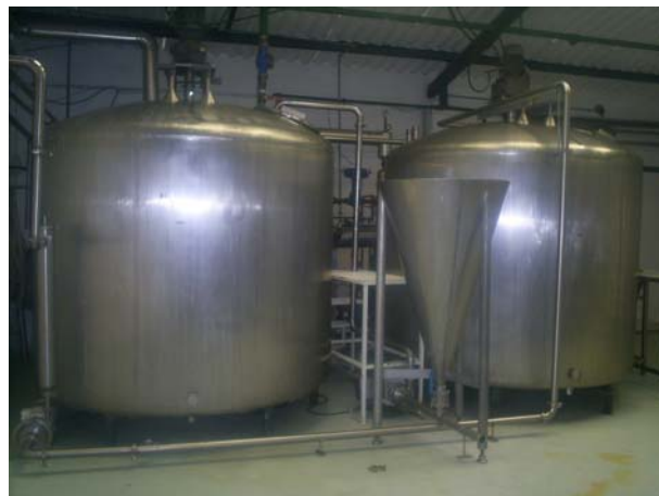
Fig. 2.13 Foto tanques de mezcla ciclo II
