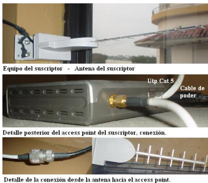
FIGURA 4.24: Equipos y conexiones en el lado del suscriptor
