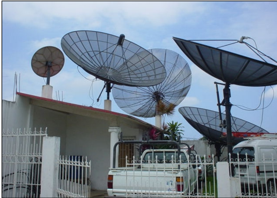
FIGURA 4.3: Localización del Telepuerto
