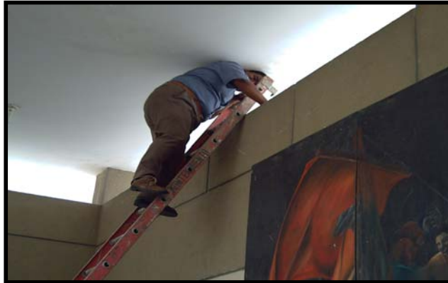
Fig 4.25 Búsqueda del lugar adecuado para colocar la antena en el edificio de tecnologías
