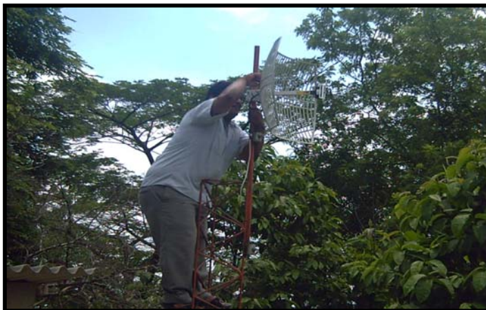
Fig 4.8 Direccionamiento de Antena
