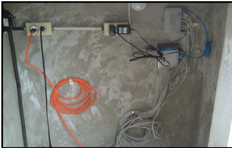
Fig 4.24 Equipos dentro de la Cabina
