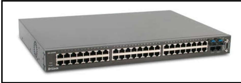
Fig. 2.11. Switch de 48 Puertos
