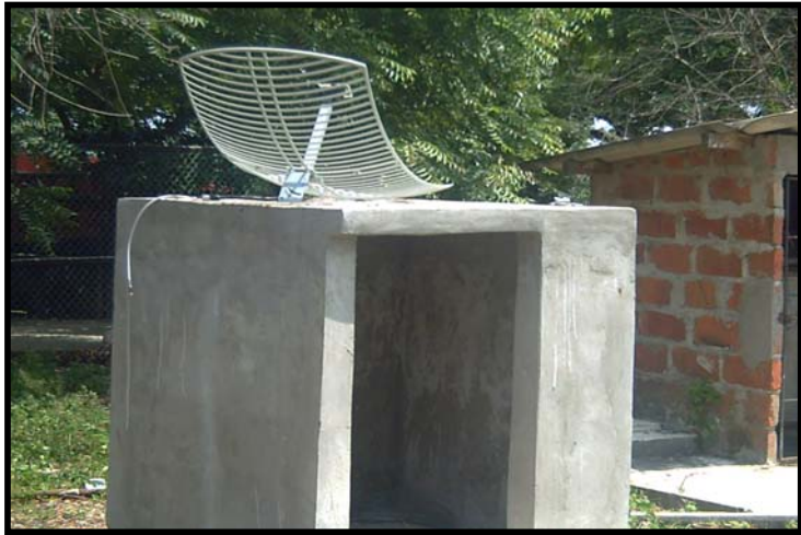
Fig 4.12 Cabina de Equipos
