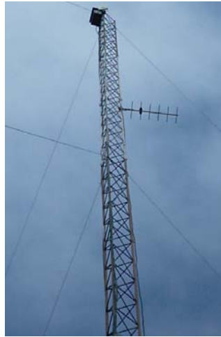
Figura 3.9 Antena transmisora en torre triangular
