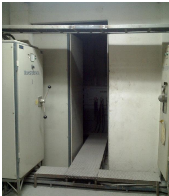
FIGURA 4.5 INGRESO AL CUARTO DE TRANSFORMADORES
