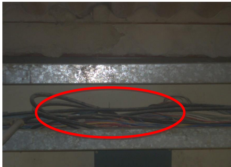
FIGURA 4.8 BANDEJA DE CABLES SECTOR MOTORES
