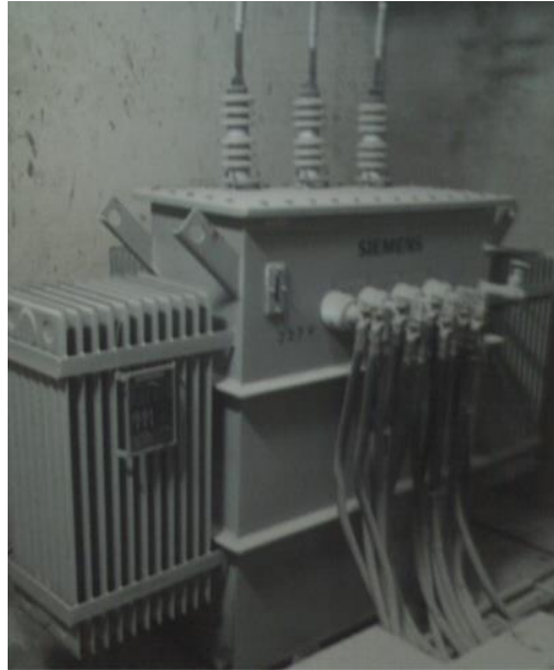
FIGURA 4.4 TRANSFORMADOR DE 500KVA
