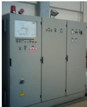
Figura 4.6 TB1 TABLERO DE DISTRIBUCIÓN
