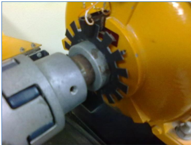
Figura 3-6 Encoder Acoplado con Sensor MOC70T3 al motor.
