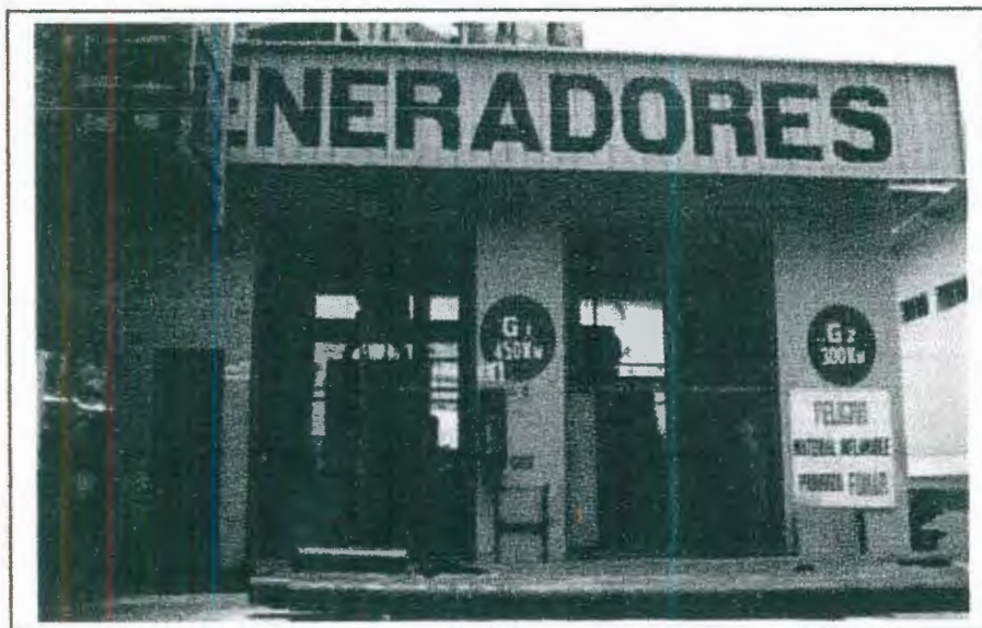
Figura 1.4 Generadores de Pabellón Valdez y Emergencia.
