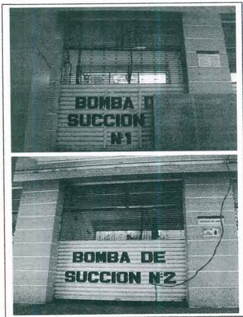
Figura 1.9 Bombas de succión del Hospital Luis Vernaza.
