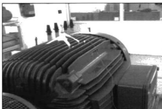
FIGURA 5.19. Medición de temperatura de bobinado.
