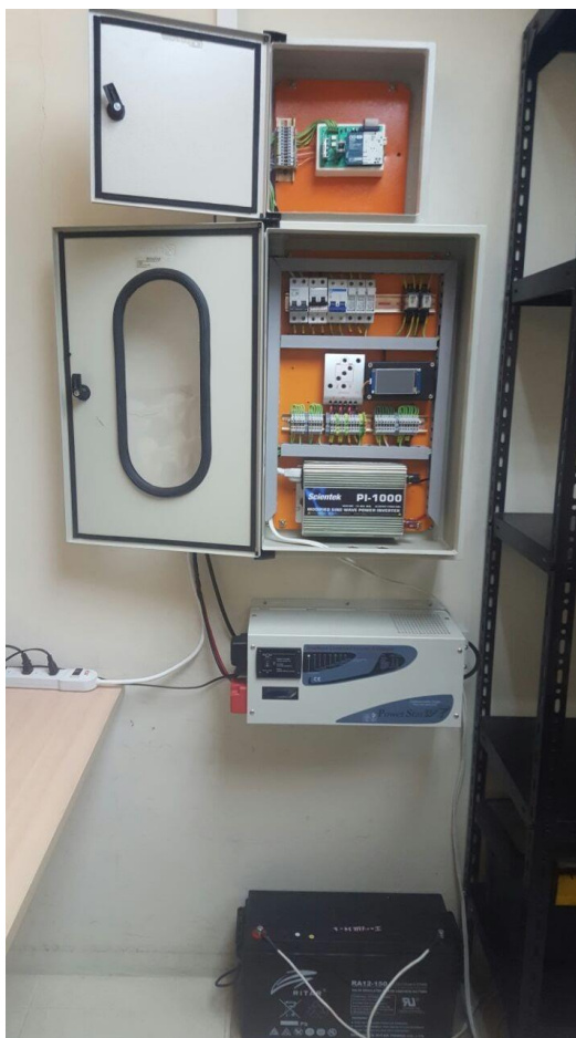
Figura 3.23: Implementación del sistema fotovoltaico
