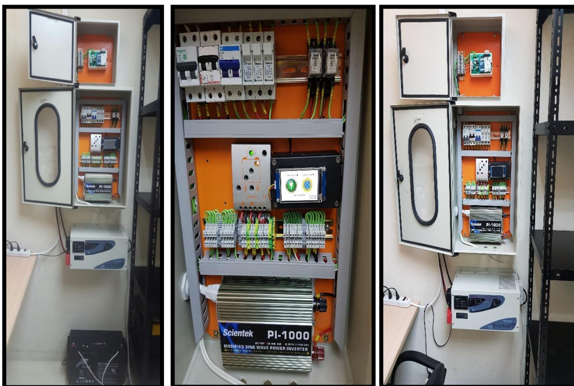
Figura 4.5: Implementación del Sistema Modular Fotovoltaico Funcional en el CIDIS
