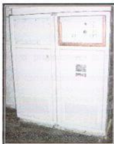
Figura No. 2-3 Convertidor de Señales de Datos
