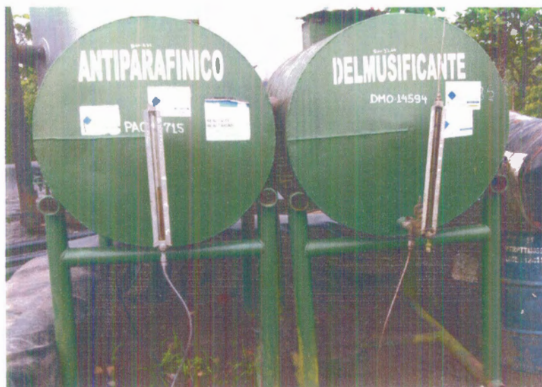
FIGURA 3.19 Tanques Contenedores de Químicos.
