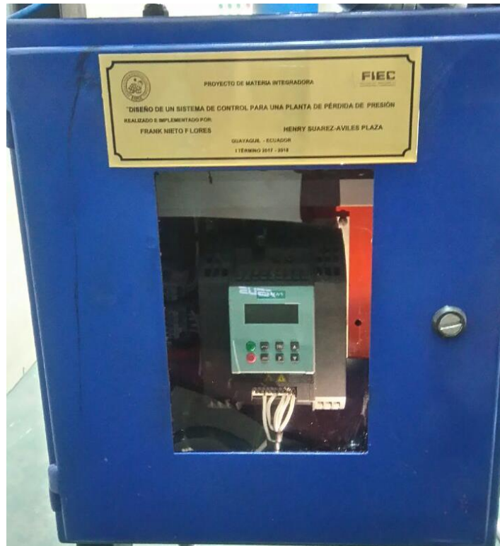
Fig 4. Vista externa del panel del variador de frecuencia
