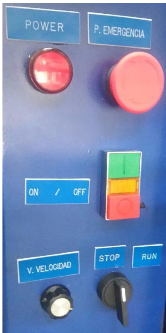
Figura 4-12 Vista lateral del panel del variador de velocidad donde se encuentran los controles del panel
