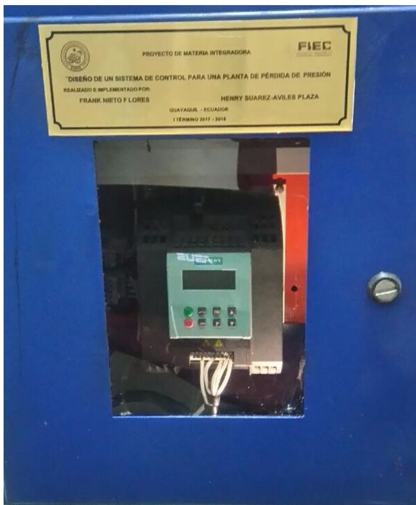
Figura 4-11 vista externa del panel del variador de velocidad
