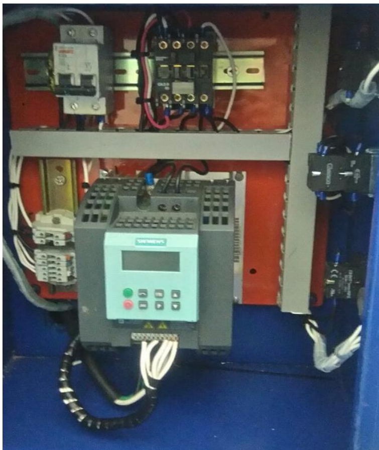
Figura 4-13 Vista interna del panel del variador de velocidad
