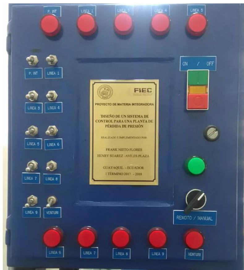
Figura 4-6 Vista frontal del tablero
