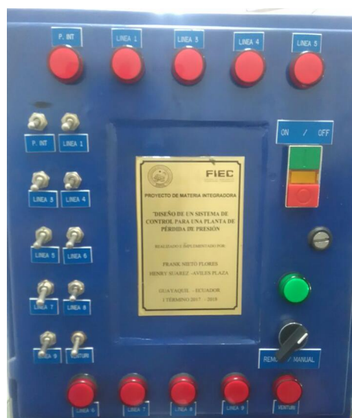
Fig 1. Vista externa del panel de instrumentación y control
