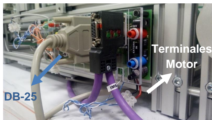
Figura 2.13: Esclavo PROFIBUS - DP, con entrada DB) y terminales del motor.
