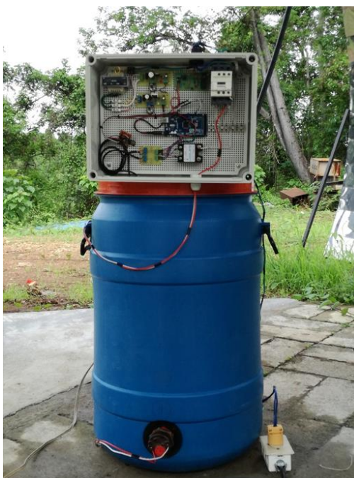
Figura 3.1: Sistema de calefacción
