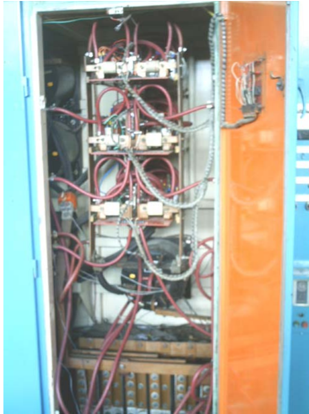
FIGURA. 1.3. PUERTA 2, CON INSTALACIÓN MODIFICADA.
