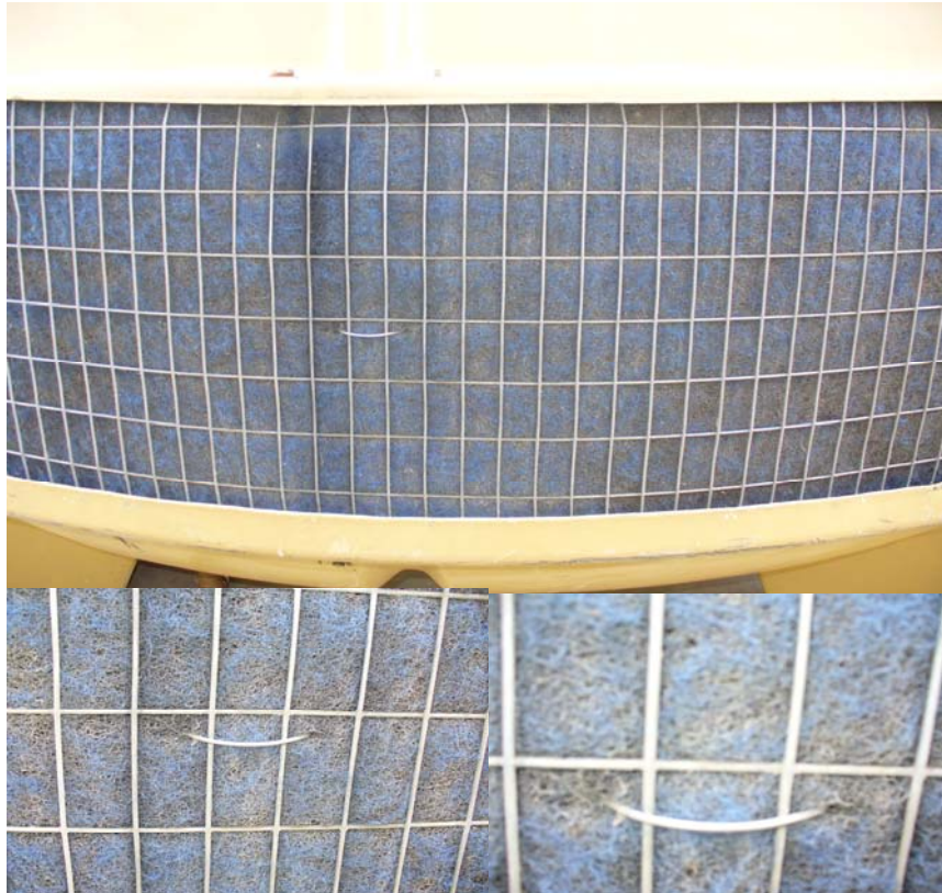
FIGURA 4.4. POLVO PRESENTE EN EL FILTRO DE LA TORRE.
