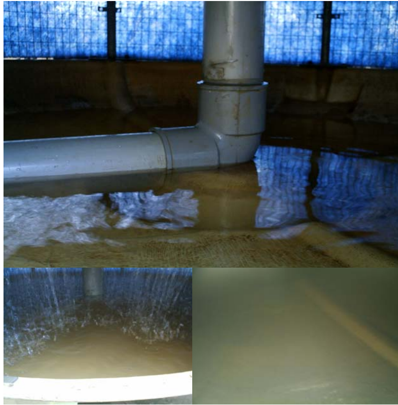
FIGURA 4.5. CONTAMINACIÓN DEL AGUA DE LA TINA COLECTORA.
