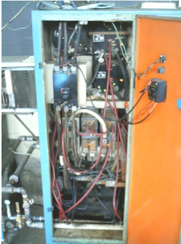
FIGURA. 1.2. PUERTA 1, CON INSTALACIÓN MODIFICADA.
