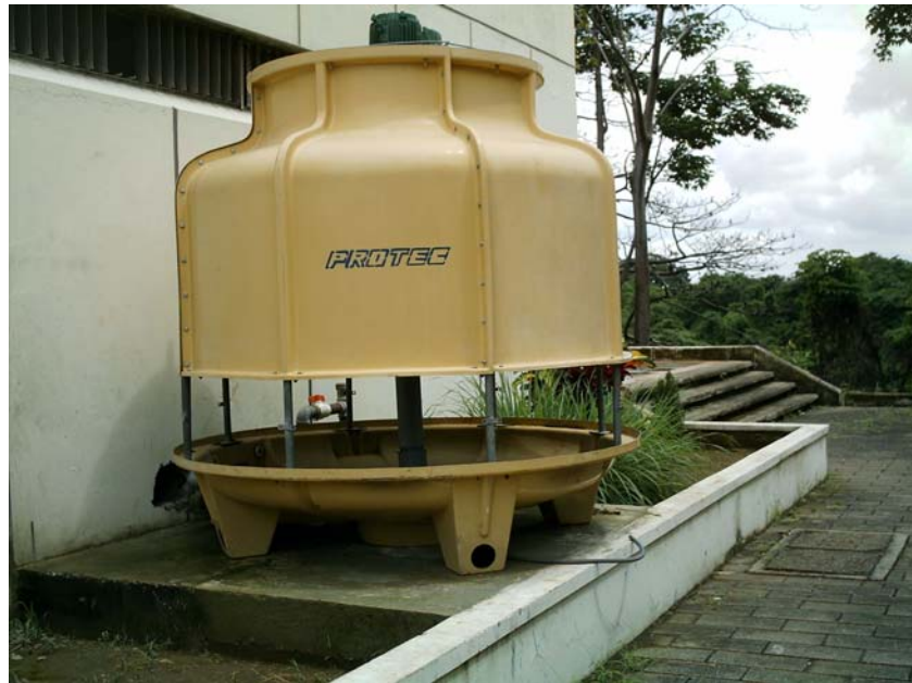
FIGURA 3.1. TORRE YA PRESENTADA, EN EL SITIO DE TRABAJO
