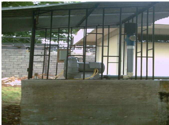
Fig. 10. Blower nuevo con arrancador eléctrico y caseta de protección y seguridad “(Tomado de la experimentación, 2006)”.
