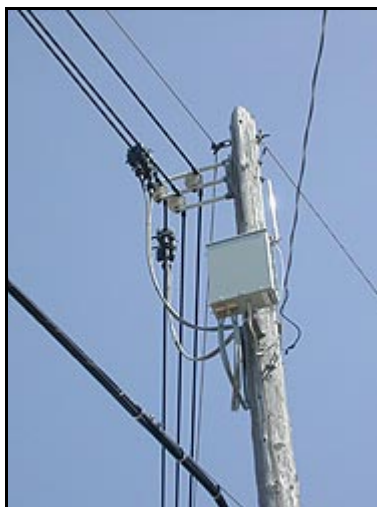
Figura 3.3. Extractor y Repetidor BPL
