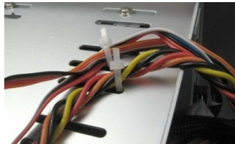
Figura 1.5 – Exceso de cables en Sistema de alarmas actuales [3]
