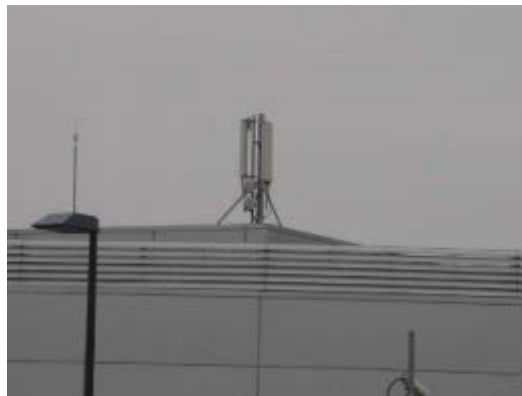
FIGURA 3-6 ANTENA EN MÁSTIL
