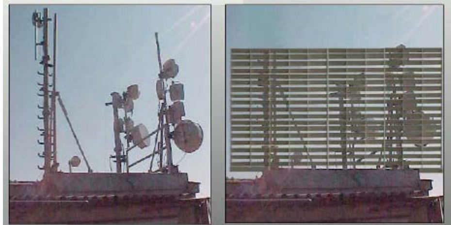
FIGURA 3-9 MÁSTILES EN AZOTEA
