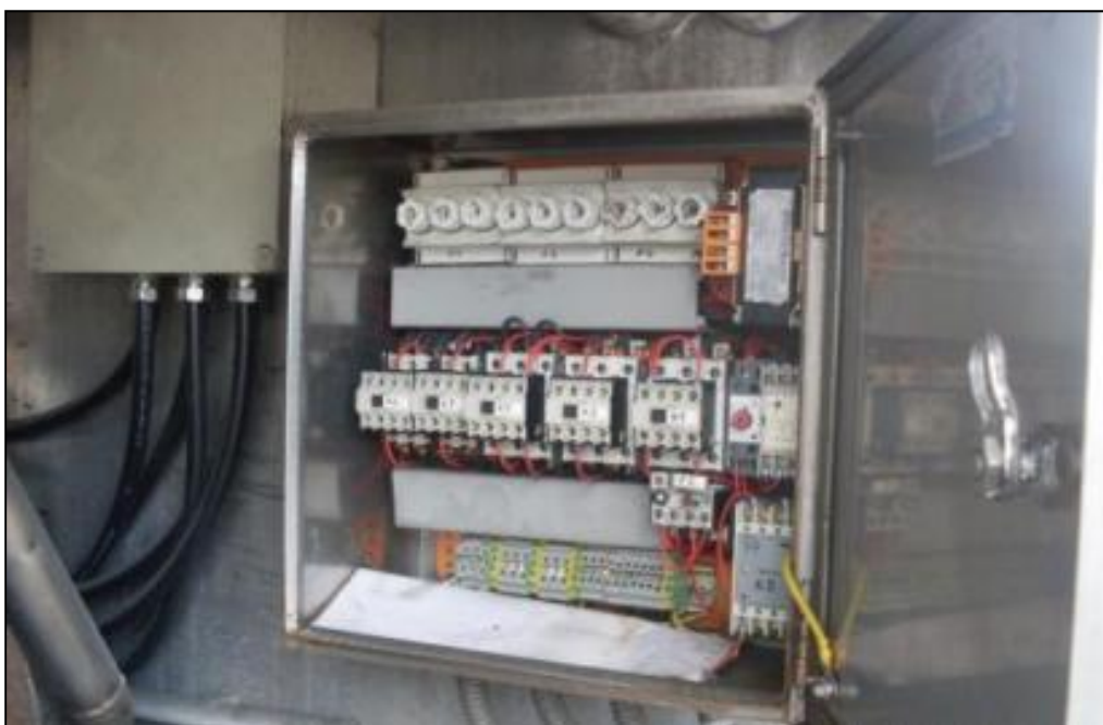
Figura 2.14. Tablero eléctrico de fuerza y control
