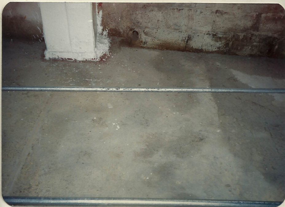
FALTA DE ADHERENCIA
