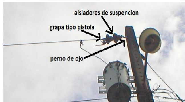
Figura 45: Estructura monofásica retenida con su respectivos elementos.
