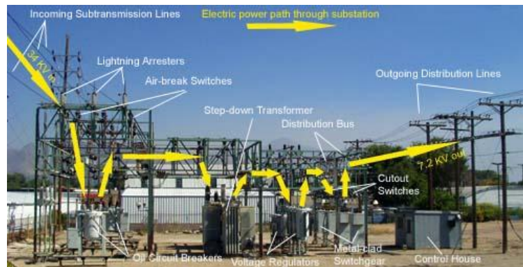
Figura 84: Vista de una subestacion clasica tomado de www. Electric Power e Tool. Com.
