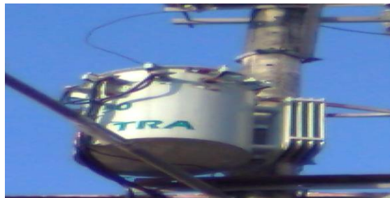
Figura 20: En las redes de distribución del centro de Babahoyo, muestra un Transformador de 50 Kva monofásico autoprotegido.
