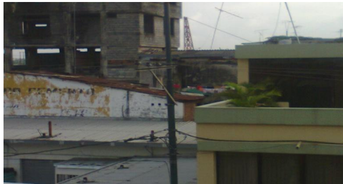
Figura 81: Vista de un poste metálico vestido con estructura en volado pasante en media tension y estructura de retencion en baja tension.
