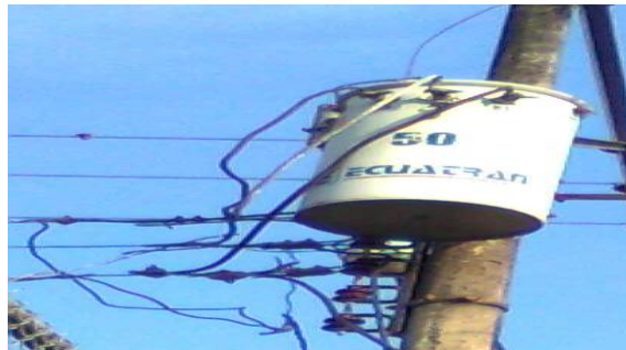
Figura 21: Foto tomada en las redes de distribución de Babahoyo muestra un Transformador monofásico de 50 Kva tipo poste sumergido en aceite.
