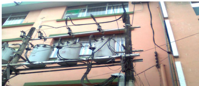
Figura 23: Banco de Transformadores monofásico en conexión estrella -estrella.
