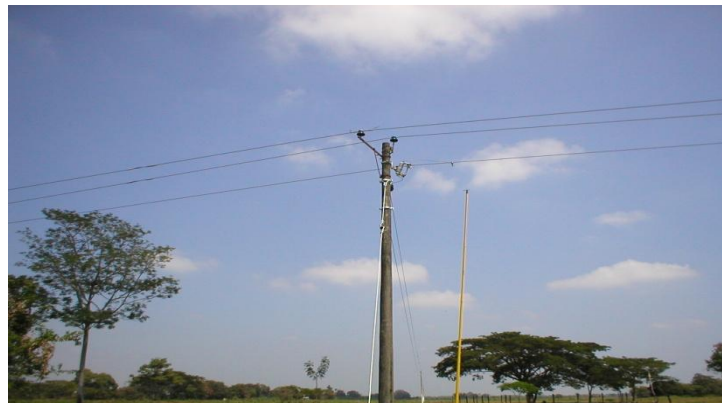
Figura 82: Vista de un poste de hormigón centrifugado vestido con una estructura en media tension centrada pasante.
