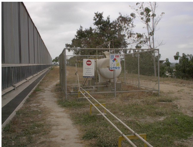
FIGURA 2.4: TANQUE DE GLP (SALA DE ADITIVOS)
