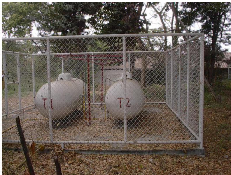
FIGURA 2.5: TANQUES DE GLP EN AREA DE COMEDOR
