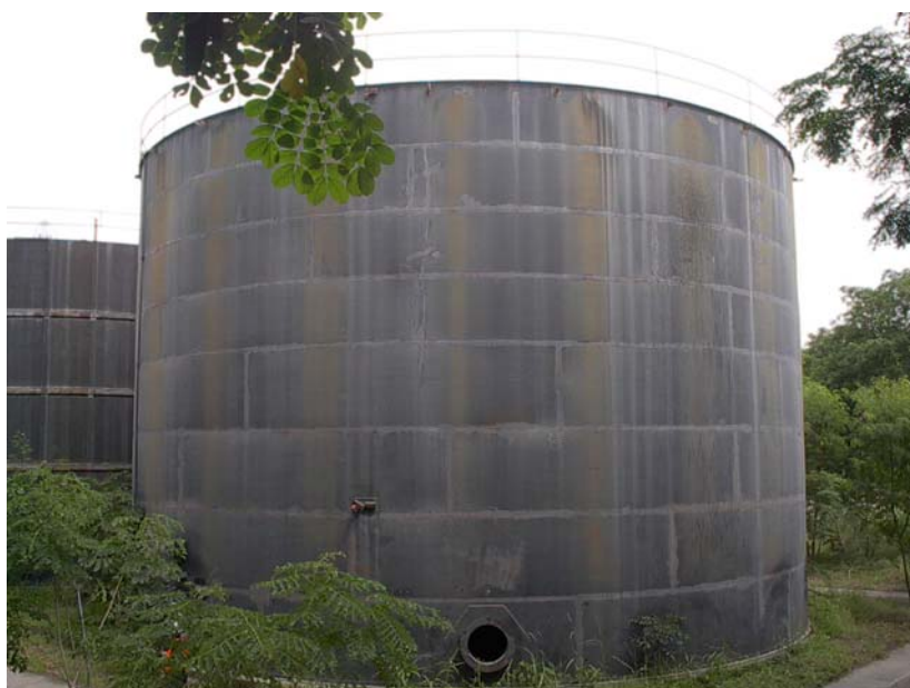
FIGURA 1.4: TANQUE DE ALMACENAMIENTO
