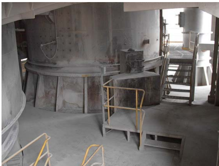
FIGURA 2.6: ZONA DE PRECALENTADORES
