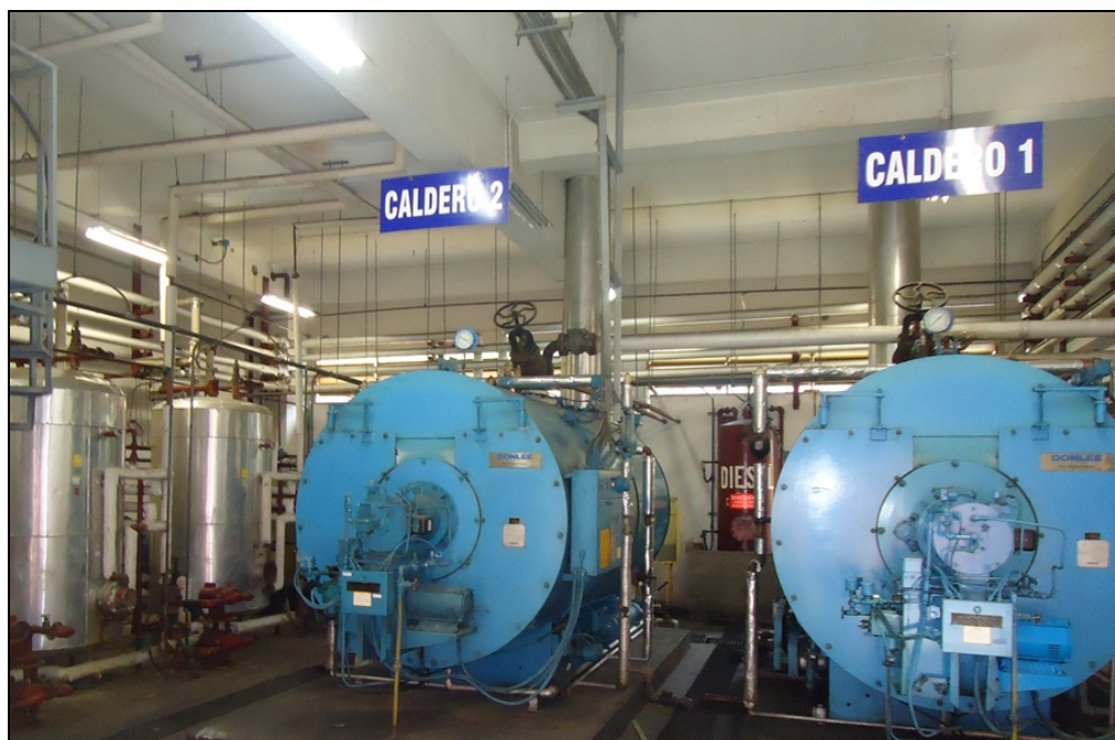
Figura 1.3 Cuarto de calderos del Hospital “Roberto Gilbert Elizalde”
