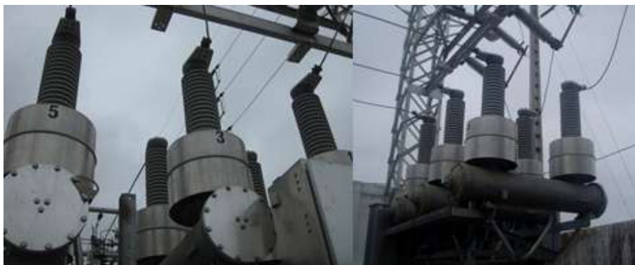
Figura 1.6 Vistas frontal y lateral de los CTs incorporados al interruptor en gas SF6.
