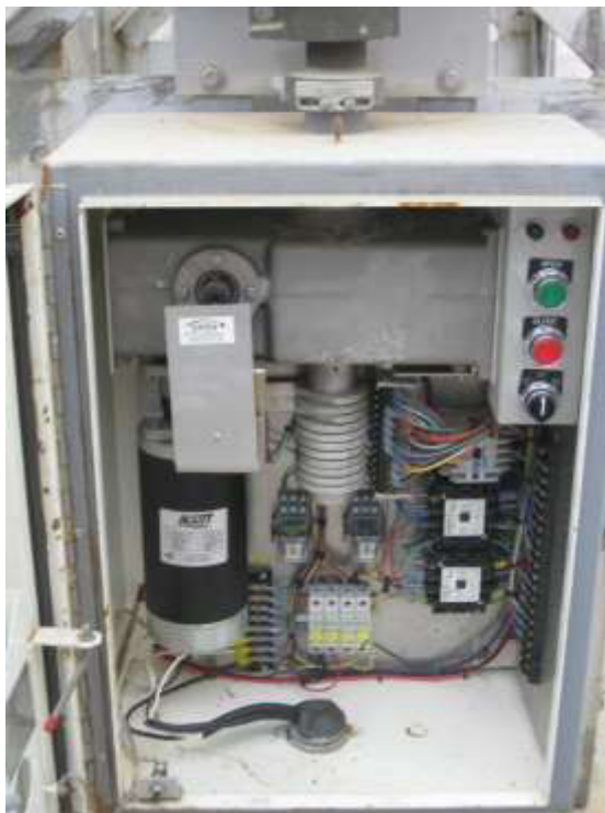
Figura 1.4 Controlador del motor del Seccionador de 69 KV.
