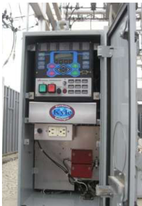
Figura 1.9 Vista interna del controlador Cooper forma 6.
