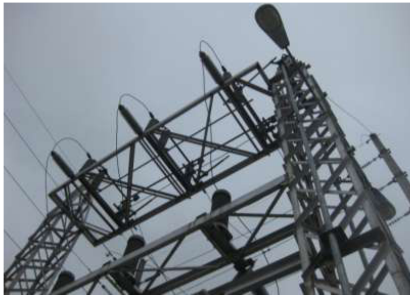
Figura 1.3 Vista de la estructura de 69 KV
