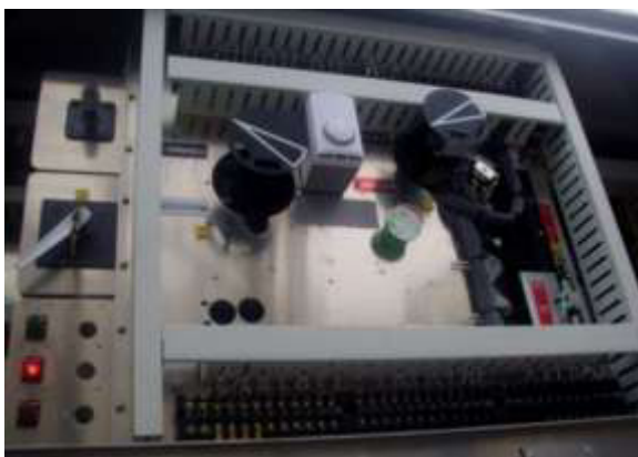
Figura 1.5 Vista interior del control del interruptor SF6.
