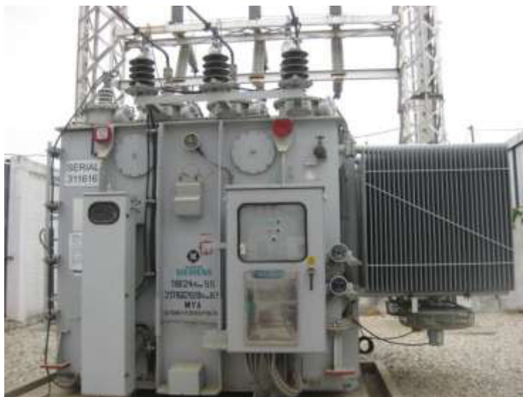
Figura 1.7 Transformador de potencia 67000/13800 V, marca SIEMENS
