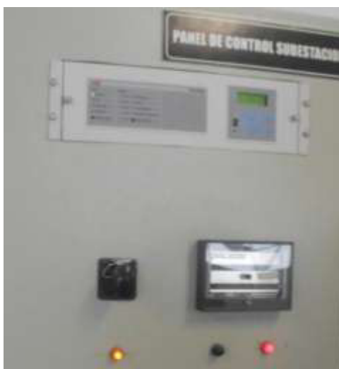
Figura 1.14 Panel de control con el relé TPU2000R.
