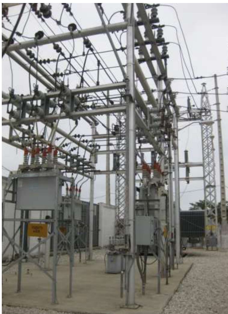
Figura 1.8 Patio de 13.8 KV.
