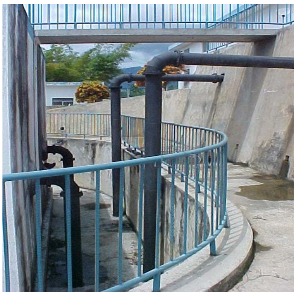
Foto N° 1: Planta de Agua Potable San José Fuente: Municipio de Portovelo
