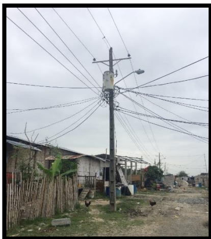
Figura 1-7 Poste de energía eléctrica, recinto La Unión
