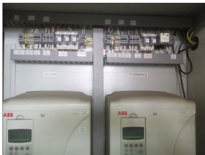
Figura 5: Tablero FORMING/SIZING Variadores
