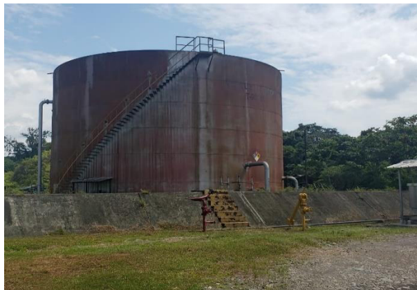
Figura 1.9 Tanque de lavado
