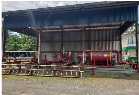
Figura 1.13 Sistema contra incendios
