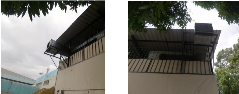
Figura 2.16 Ductos de salida del sistema de evacuación de gases. (Autores, 2020)
