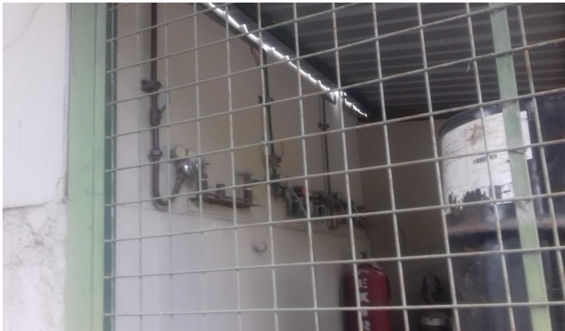
Cuarto de gases “Líneas de tuberías”
