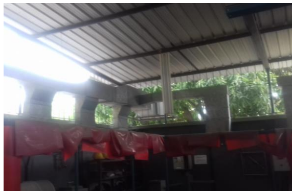
Figura 2.15 Sistema de evacuación de gases del laboratorio. (Autores, 2020)
