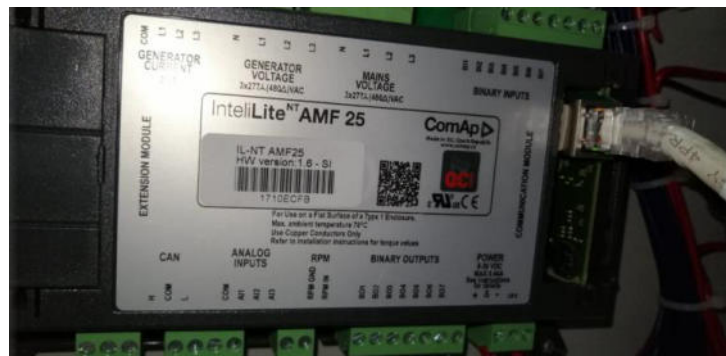
Figura 2.15 Tarjeta controladora de generador.
