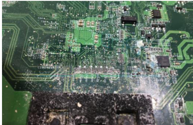
Figura 1.4 Humedad en equipos de TI
