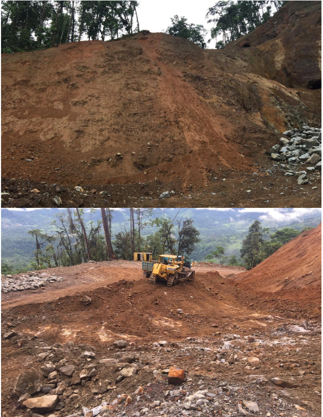
Ilustración 7.12 Deslizamiento producido por el factor lluvia y retiro del material.
