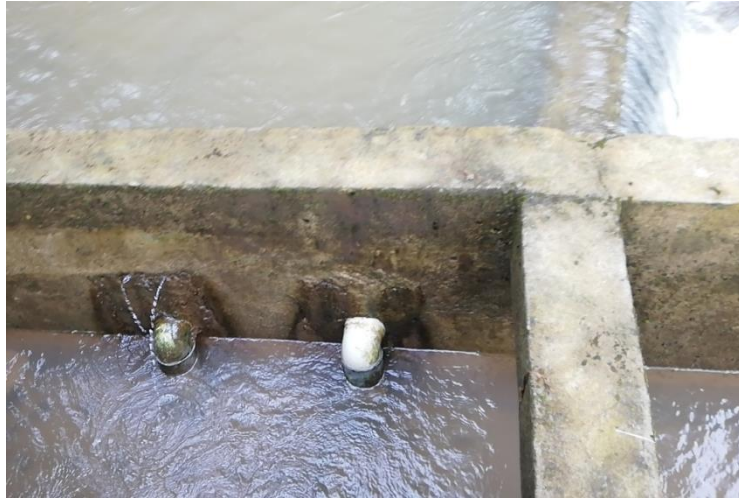
Ilustración 6.2 Tuberías de la actual toma de captación.
