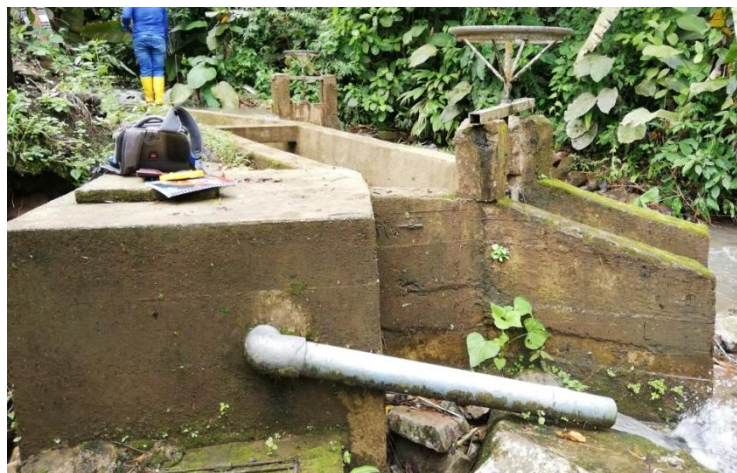
Ilustración 6.1 Actual toma de captación.
